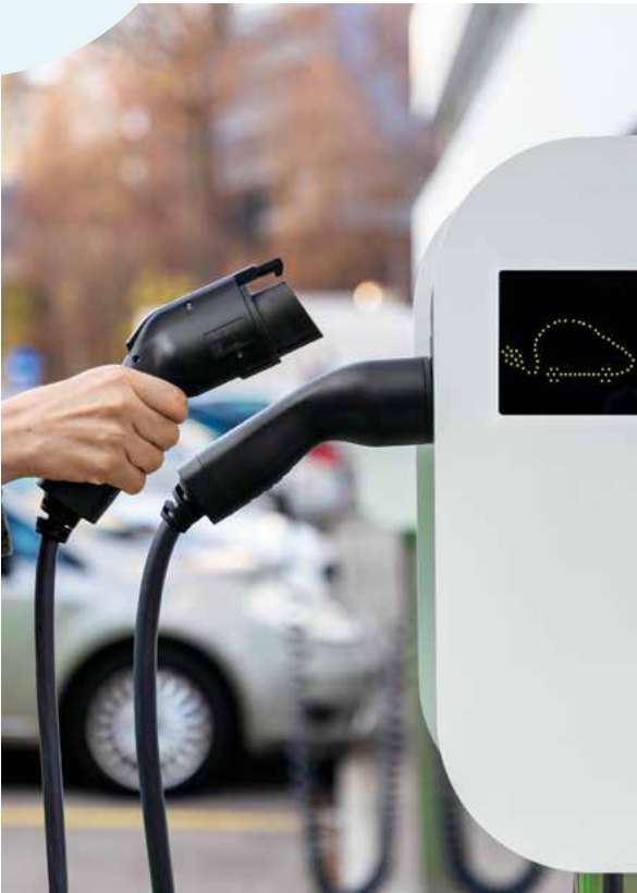
Im Jahr 2021 wurden drei Ladestationen für Hybrid- und Elektrofahrzeuge auf den Parkplätzen der Loterie Romande installiert.
